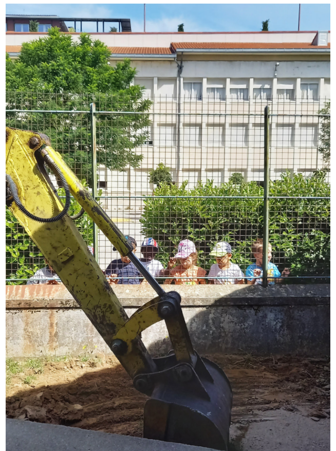
Préparation du bac à sable à la mini-pelle, sous le regard émerveillé d'élèves, admiratifs devant la force de frappe des techniciens de la ville.
