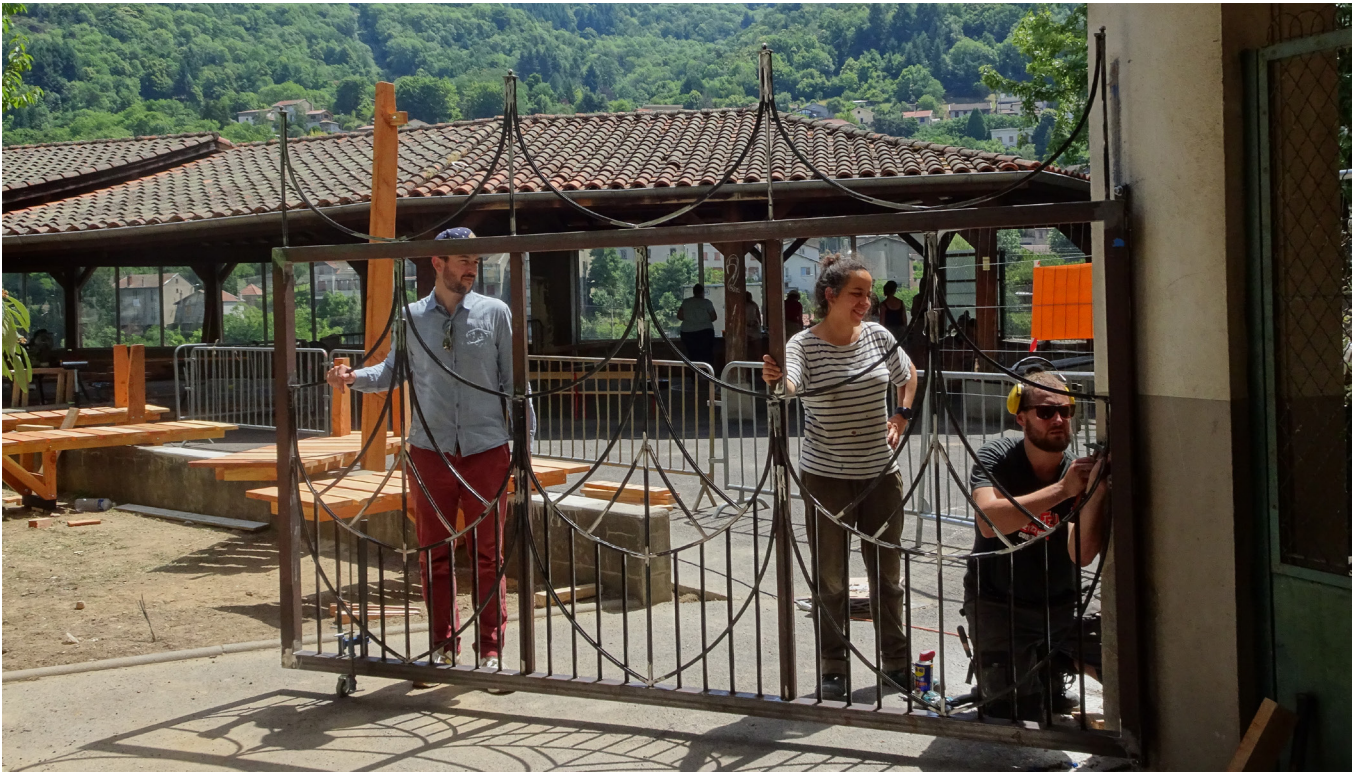
Mise en place du portail sur site, à la place d'un muret et d'une grille fixes : une porosité s'opère entre école et quartier.
